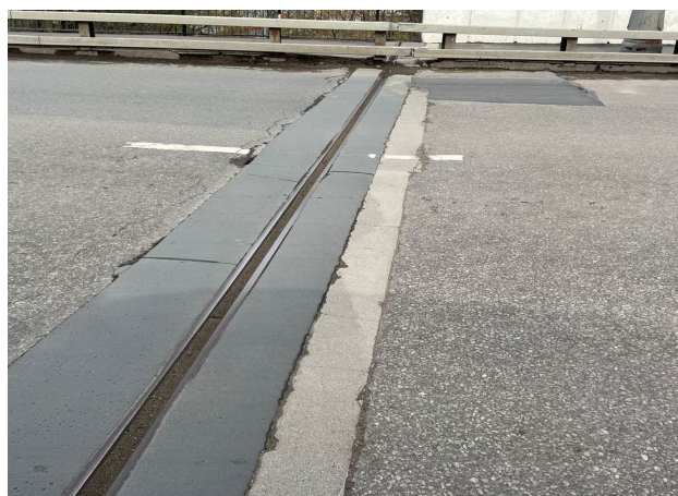
Рис. 1. Повреждения переходных зон деформационных швов эксплуатируемых мостовых сооружений
