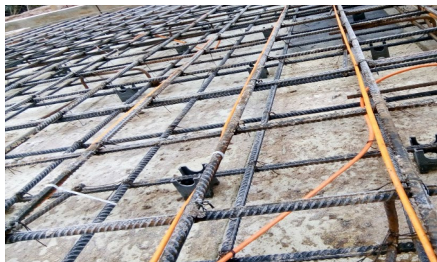
Рис. 4. Крепление греющего провода при помощи пластиковых хомутов-стяжек и вязальной проволоки Fig. 4. Fixing the heating cable with plastic tie clamps and binding wire
