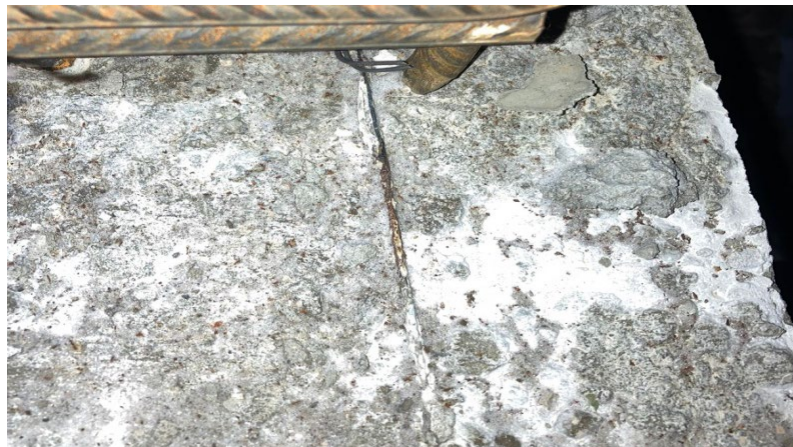
Рис. 2. Оплавившийся «всплывший» провод
