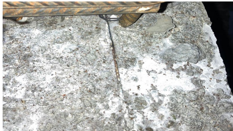
Рис. 2. Оплавившийся «всплывший» провод
